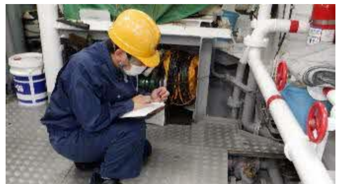
プレートの下にも重要な機器が隠れています！
