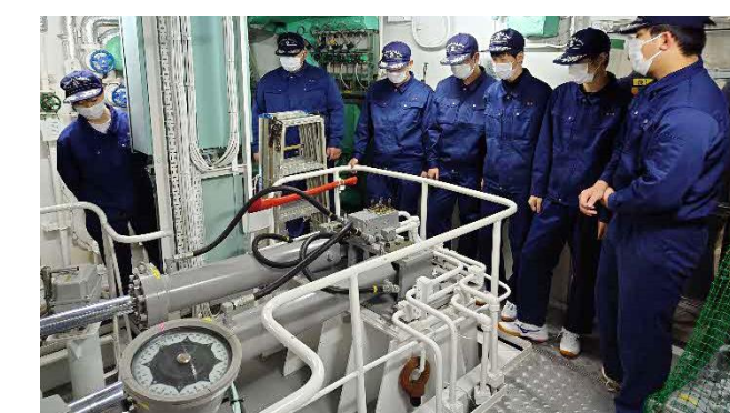
大きな舵を油圧によって動かします。圧力や作動油、配管等注視するポイントがあります。
